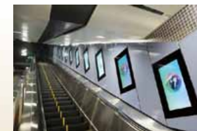
Ruchome schody na stacji
